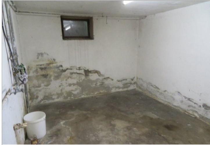
25 Kellergeschoss mit aufsteigender Feuchtigkeit
