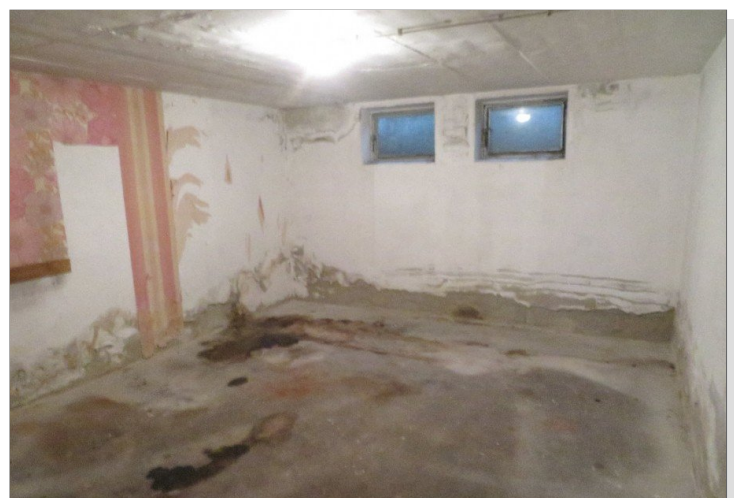
24 Kellergeschoss mit aufsteigender Feuchtigkeit
