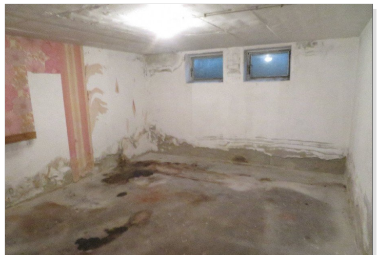
24 Kellergeschoss mit aufsteigender Feuchtigkeit
